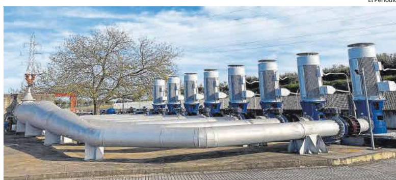
Estación de bombeo del sector VIII de la Comunidad de Regantes del Canal del Zújar.
